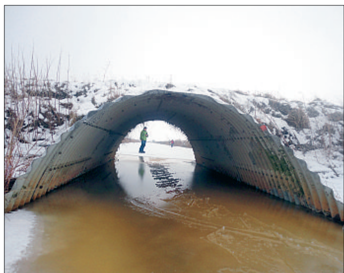
Durchblick: Zwischen dem Dornumersiel Pumpstief und dem Mahlbussen galt es noch, diesen Tunnel zu durchqueren.
